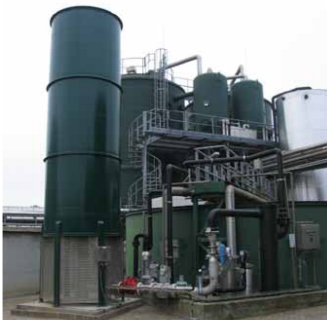
NER Fakkelinstallatie in bedrijf
